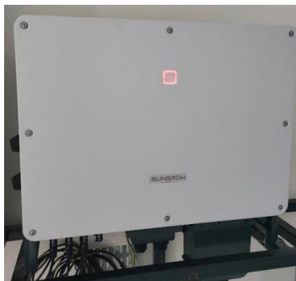
Gambar 10. GTI yang sedang dalam kondisi Islanding .
