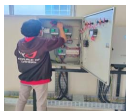
Gambar 3. Panel Kontrol untuk Monitoring.
